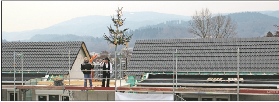
Zimmermanns-Spruch: Das Lebenshilfe-Projekt Weinauer Straße 12 soll noch in diesem Jahr fertiggestellt werden. Foto: Juch
